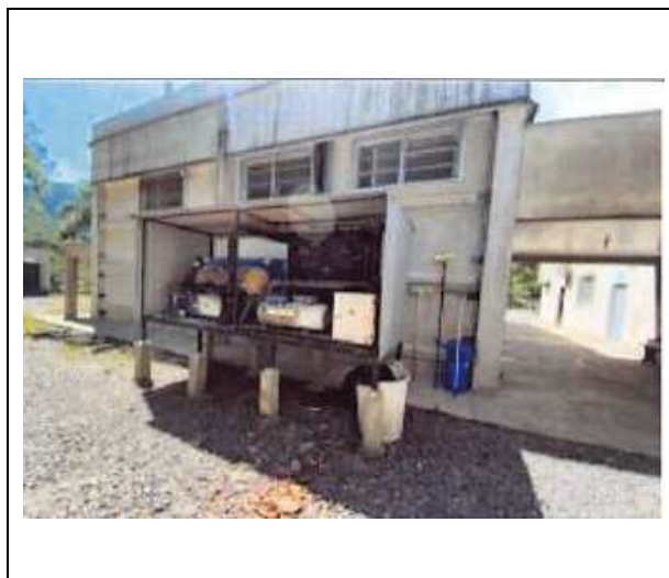
ITEM 4 - COMPRESSOR / MOTOR (TÚNEL DE CONGELAMENTO)
