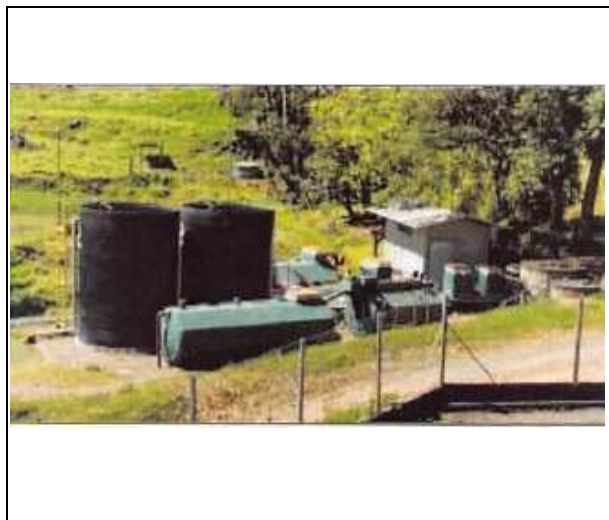
ITEM 2 - RESERVATÓRIOS (BOMBEADO, PULMÃO, RECICLO, FLUTUADOR, IODO, OXIGENADOR, BOMBAS, COMPRESSORES)
