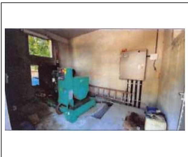
ITEM 17 - GERADOR DE ENERGIA ABERTO, CUMMINS, C/ PAINEL DE COMANDO DIGITAL
