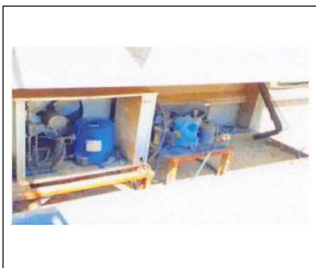
ITEM 15 - COMPRESSOR / MOTOR (CÂMARA DE ESTOCAGEM)
