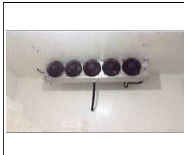
ITEM 14 - EVAPORADORES (CÂMARA DE ESTOCAGEM)
