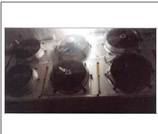
ITEM 3 - EVAPORADORES (TÚNEL DE CONGELAMENTO)
