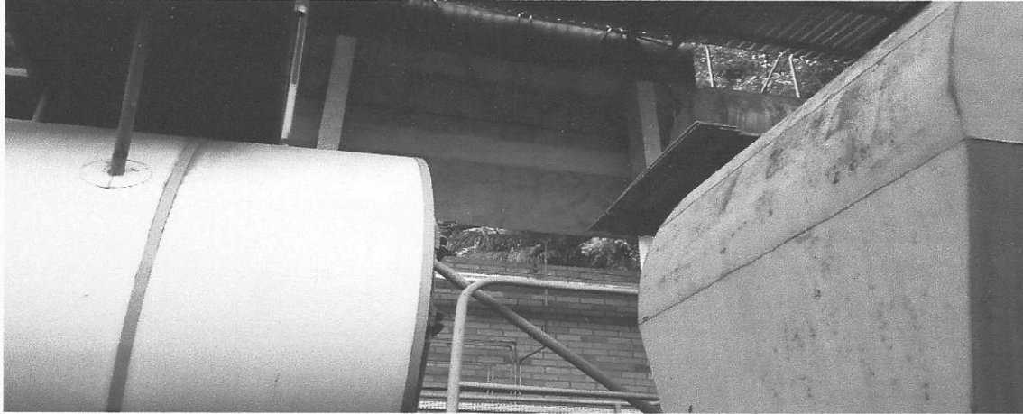
Local: Galpão caldeira
