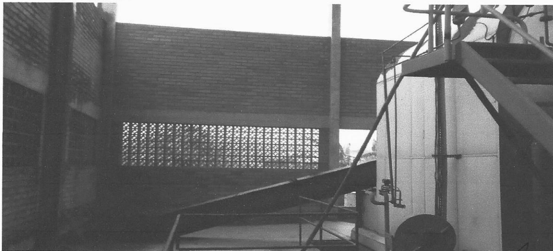
Local: Galpão caldeira
