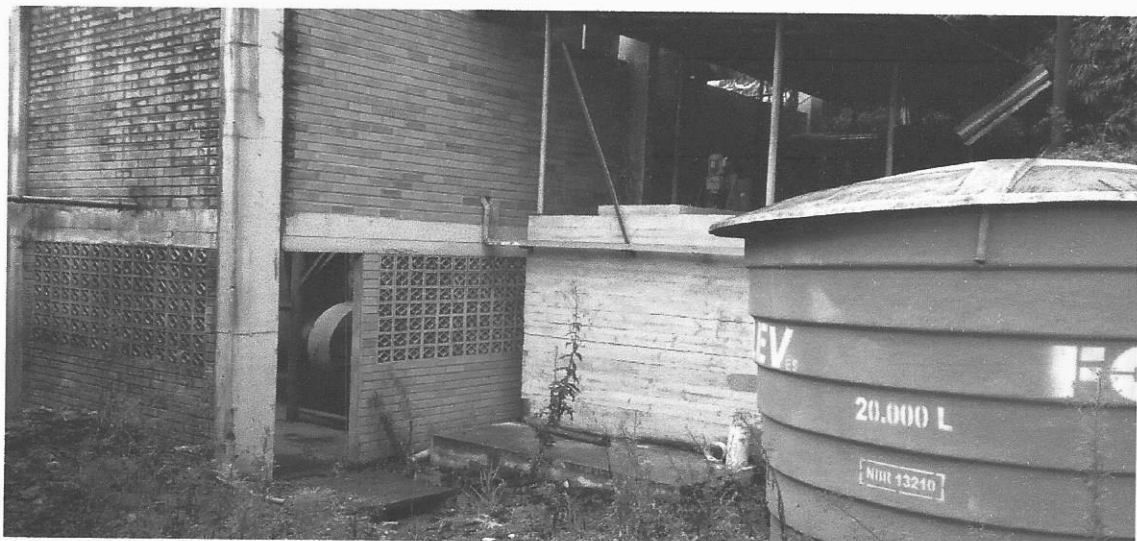
Local: Galpão caldeira
