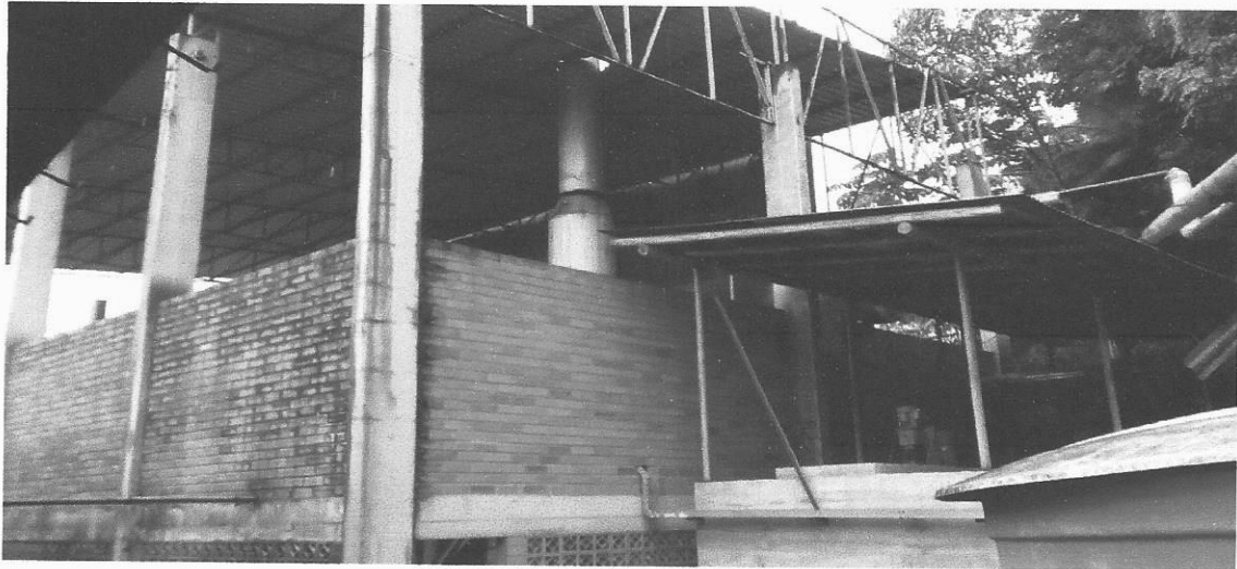
Local: Galpão caldeira
