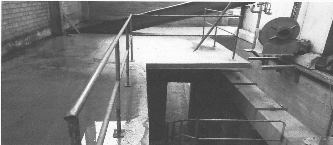
Local: Galpão caldeira
