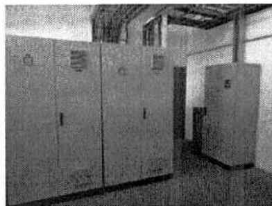
PAINÉIS ELÉTRICOS E PAINEL PARA FATOR POT
