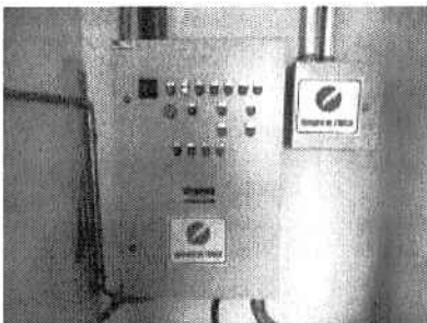
QUADRO DE FORÇA
